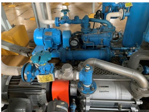
核三廠海水淡化設備
