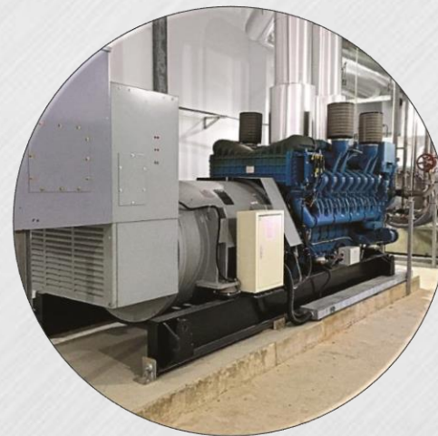
緊急發電機設備
